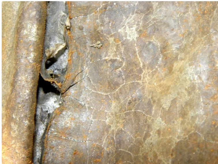
Figur 26. Närbild på ytsprickningsskadorna. I ytsprickorna syntes färskt reliningmaterial med gummikulor.
